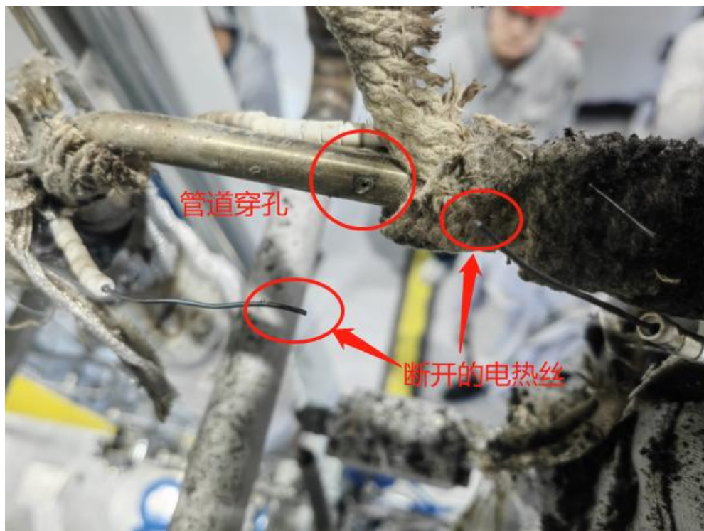
图 5 断开的电热丝、管道穿孔相对位置
